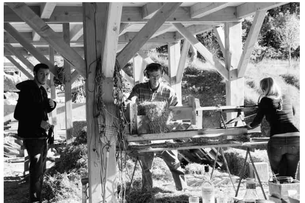
Bouw in de Provence: stobalen worden in vorm geperst voordat ze worden gebruikt om het vakwerk te vullen.
